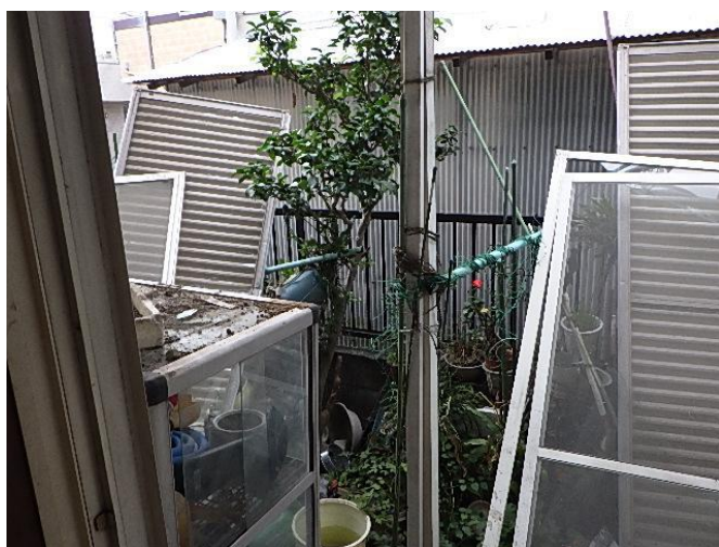
写真 12-1 爆発による窓ガラス等の破損状況
