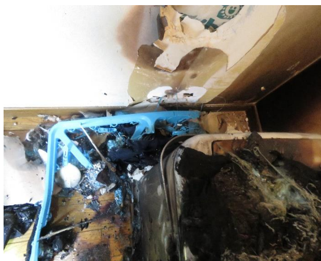
写真 8-4 石油ストーブ付近の焼損状況
