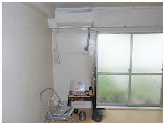
写真 5-1 木製台付近の焼損状況
