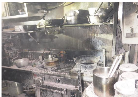
写真 19-4 厨房の焼損状況
