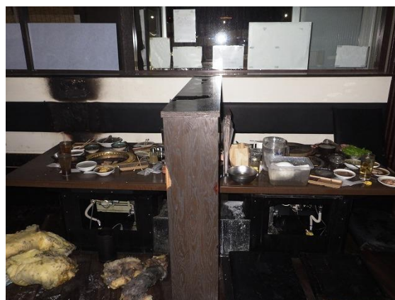
写真 27-1 焼損箇所付近の状況
