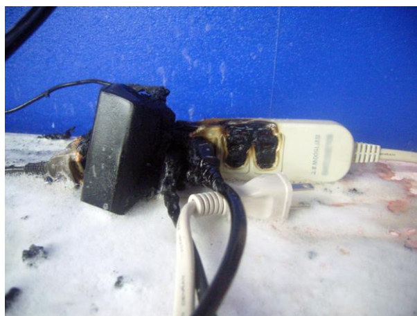
写真 28-2 出火箇所の状況
