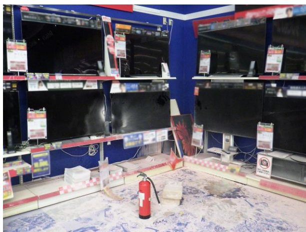
写真 28-1 焼損箇所の状況
