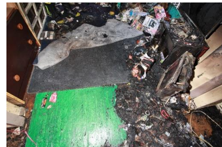
写真 11-2 居室の焼損状況
