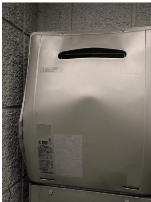
写真 12-2 焼損したガス給湯器の状況
