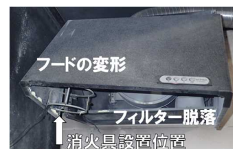
図 22 衝撃により破損したレンジフード
