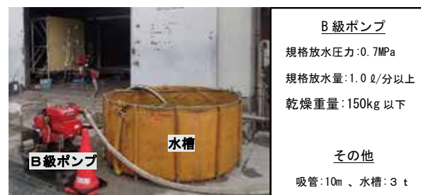
写真6 B級ポンプ等の設定状況
