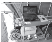
写真8 パソコン 設置状況
