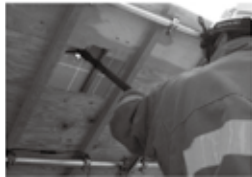
写真 14 パネル破壊状況
