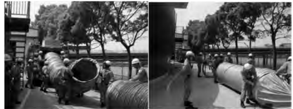
写真15 送風管の設定
