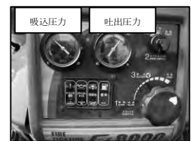
写真17 吸込・吐出圧力
