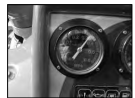
写真19 排水栓水圧 (可搬ポンプ停止時の吸込圧力)
