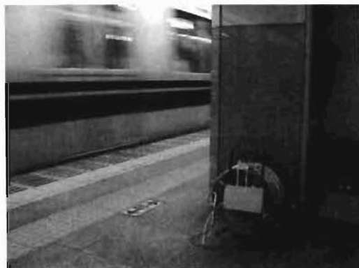
写真 9 無線通信部設定状況 (地下 3 階ホーム上)
