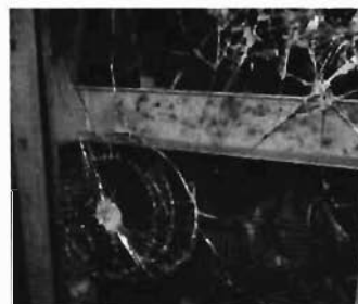
図3 フィルムを貼ったフロートガラスの破壊状況
