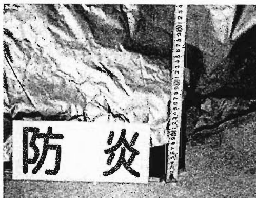
写真15 防災カバーの炭化部
