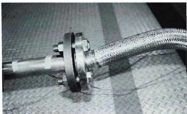
写真6 フレキシブル管の破損状況
