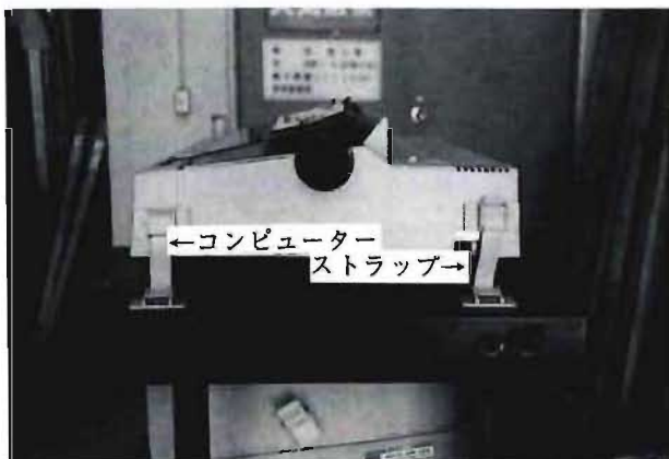
写真8 コンピュータストラップの設置状況
