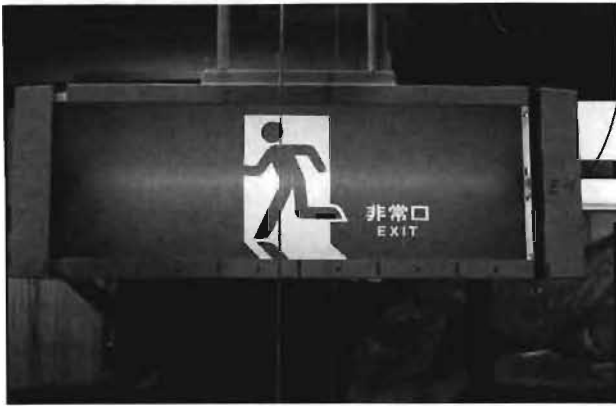
写真2 サイドカバーが左右にずれた状況
