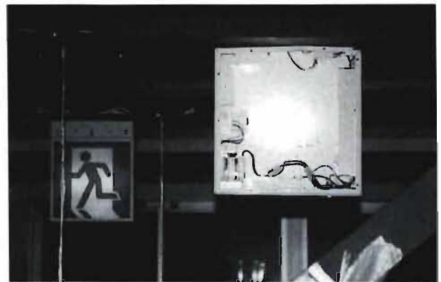
写真7 プレートが落下した状況
