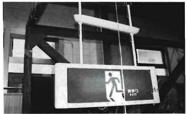
写真3 フランジカバーがずれ落ちた状況
