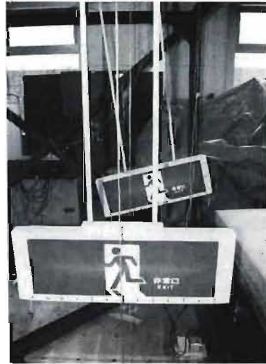
写真5 パイプ上部が外れた状況
