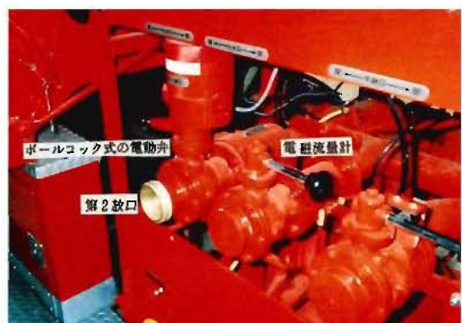
写真4 電動弁と電磁流量計
