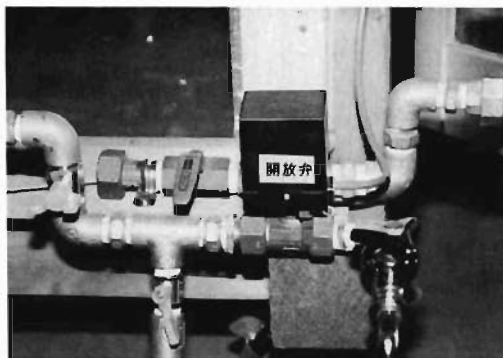
写真2 開放弁（三方切換弁）
