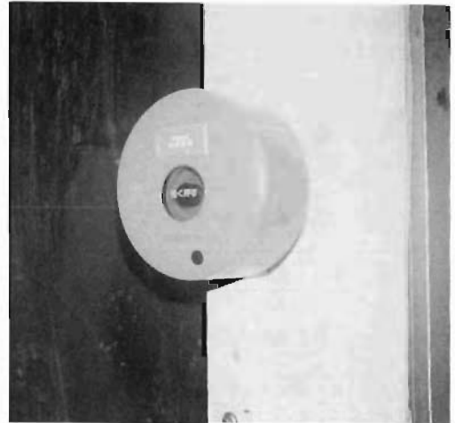
写真4 非常押しボタン
