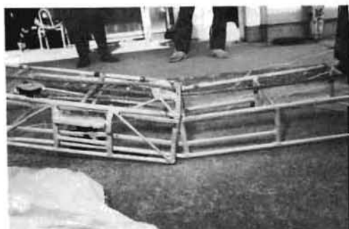
写真10 同上破壊状況
