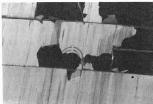
写真2 壁体の破壊状況 (4100 ℓ/min 地上高約10m)
