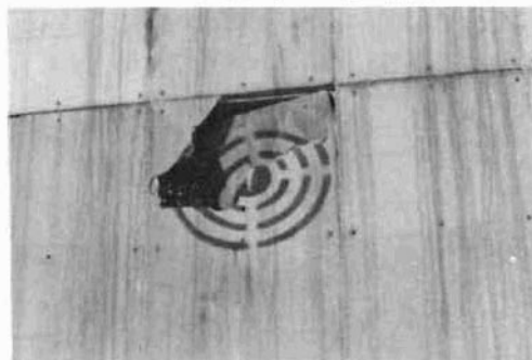
写真3 壁体の破壊状況 (2820 ℓ/min 地上高約6m)
