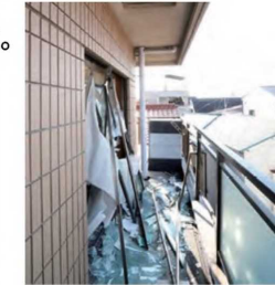
室内でストーブが原因となりスプレー缶内のガスに引火し爆発した火災 (屋外ベランダの様子)
