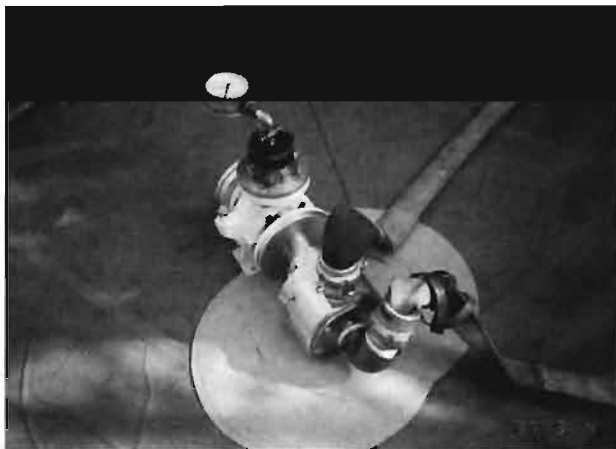
写真3 水中ポンプを水槽にセットしたところ
