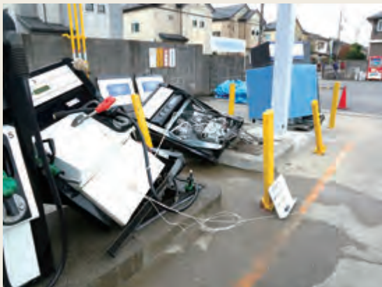
固定給油設備からの流出状況
