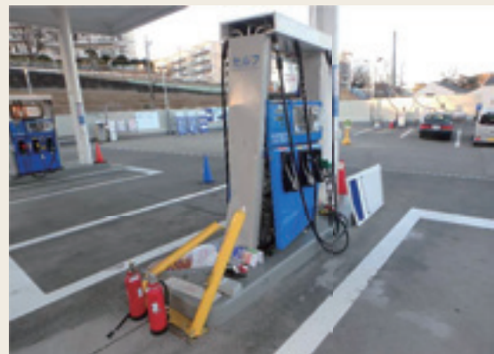
▲ 固定給油設備の破損状況
