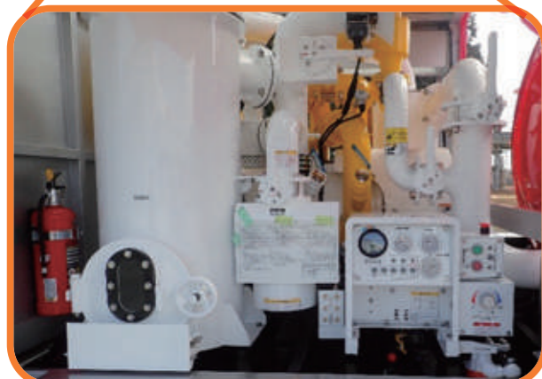
吸引装置操作盤
