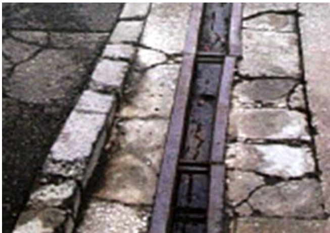
排水溝に亀裂が発生した状況 【出典】東京都石油業協同組合
