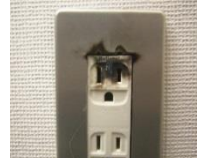
コンセントのこげ跡
