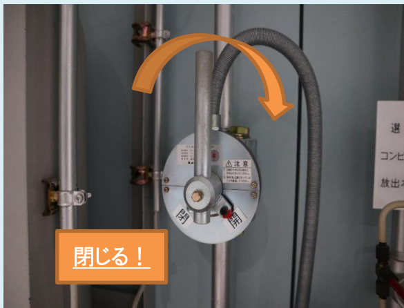
集合管に設置された 閉止弁の閉止例
