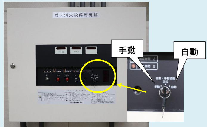
制御盤に設置された 自動手動起動切り替えの例
