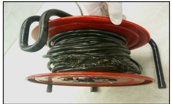
焼損したコードリール
