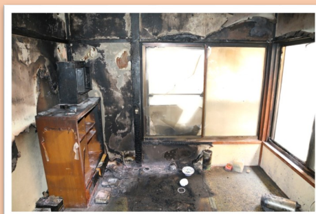
事例2 焼損状況
