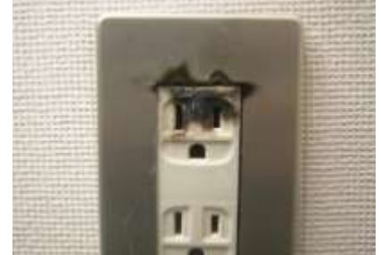
コンセントのこげ跡
