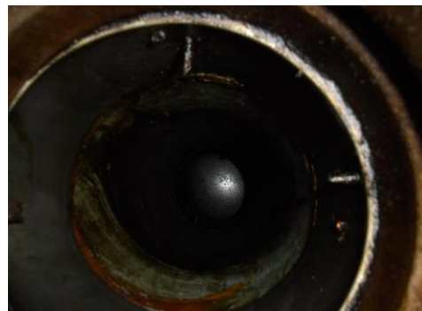
写真 5-15 店舗 E 上引きダクト
