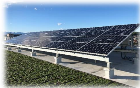
太陽光発電設備（屋上）
