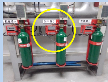
操作管に閉止弁を設置した例
