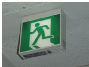
避難口誘導灯
