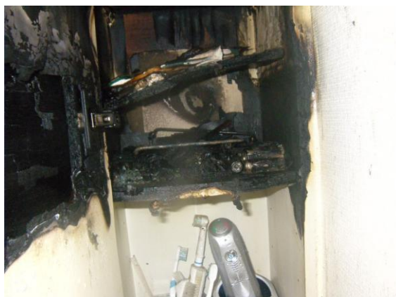
写真3 出火した棚の焼損状況
