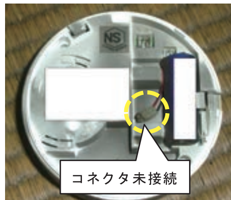
写真 6-1-9 住宅用火災警報器の状況
