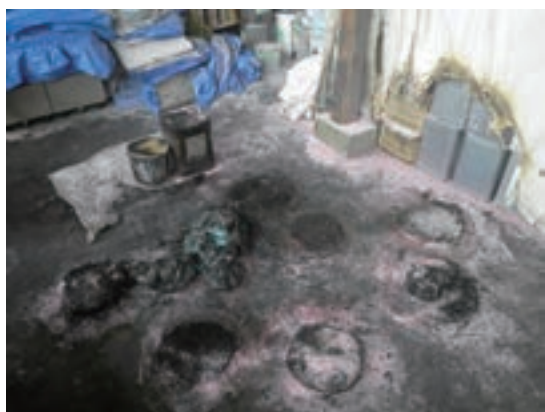
写真 6-12-4 ポリバケツ等の焼損状況
