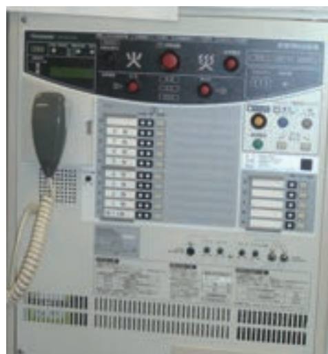
写真 8-2 放送設備の状況
