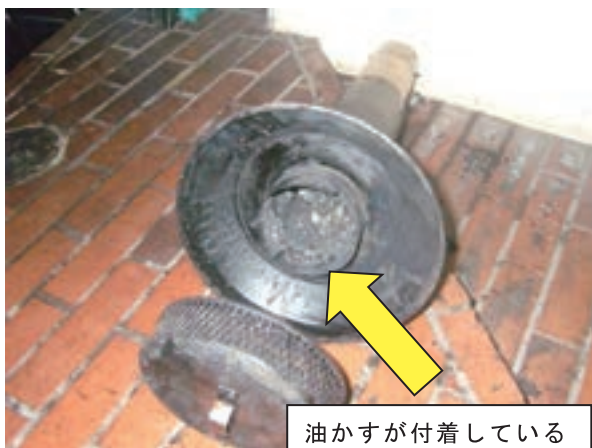
写真 6-2-4 ダクトフードの状況
