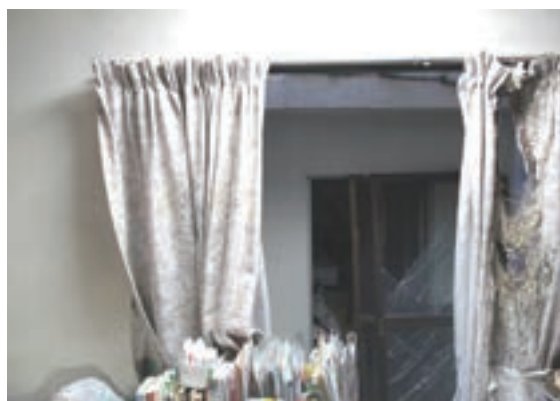
写真3-4-2 破損した窓ガラスの状況
