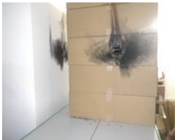
写真 6-8-2 内壁等の焼損状況
