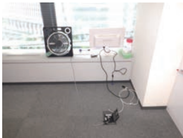
写真 6-9-2 電源コードの焼損状況
