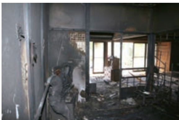
写真 2-4-3 出火した居室の状況
