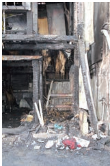
写真 2-1-4 出火箇所付近の状況
