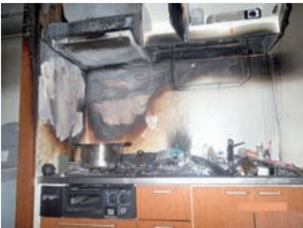
写真 3-1-3 台所の焼損状況
