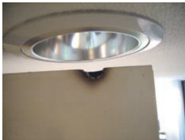
写真 2-6-2 木製扉の焼損状況
