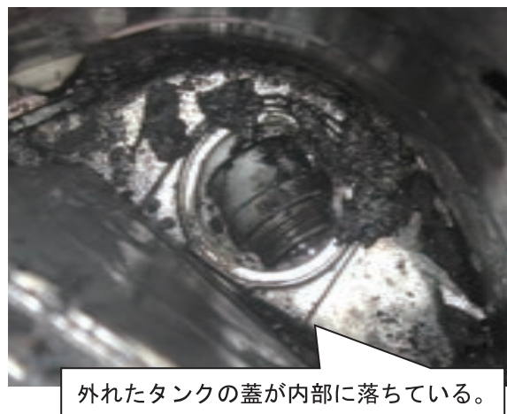
写真 5-1-4 カートリッジ挿入口の状況
