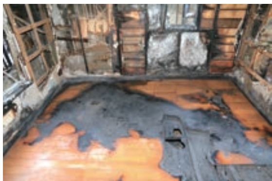
写真 2-2-3 出火箇所付近の床面
