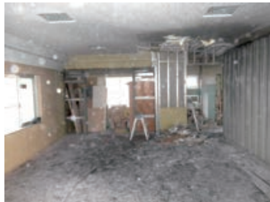
写真 5-2-3 出火箇所付近の焼損状況
