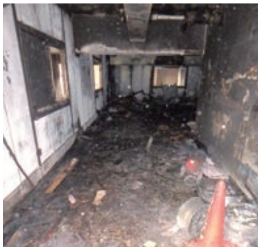
写真 5-2-2 出火箇所の状況
