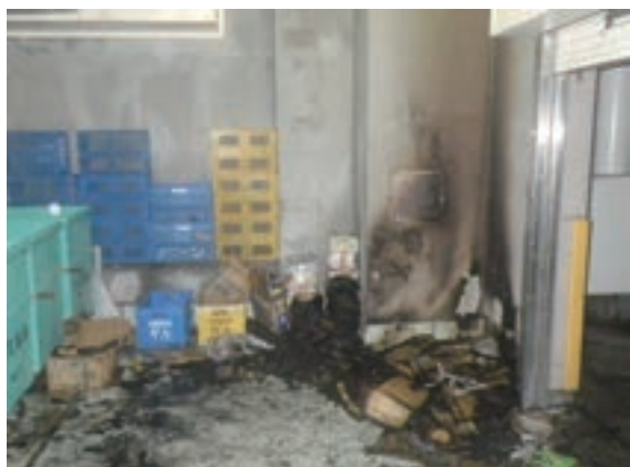
写真 2-1-1 出火箇所付近の状況
