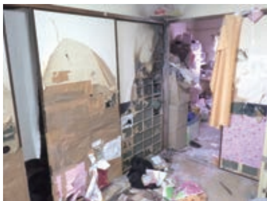
写真 2-3-1 出火室の状況
