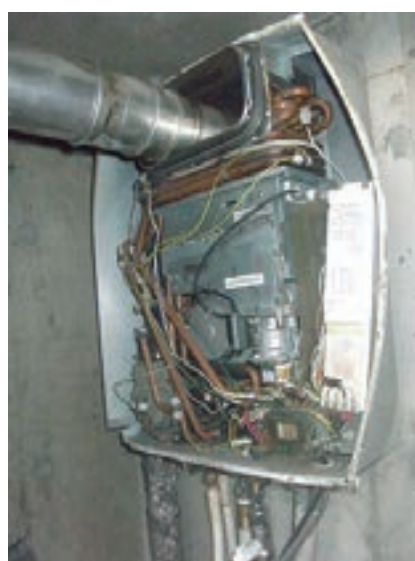
写真 3-4-4 破損した給湯器
