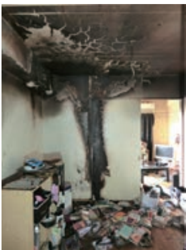
写真 2-4-1 居室の焼損状況
