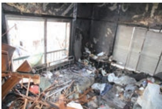
写真 4-1 出火した居室の状況
