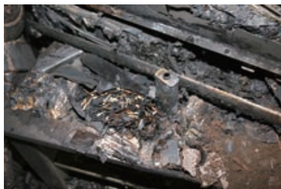
写真 2-4-4 オイル缶の周囲の焼損状況
