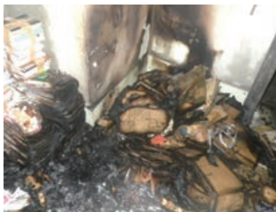
写真 2-1-2 焼損したダンボールの状況
