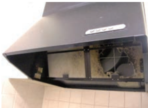
写真 3-3-1 換気扇の焼損状況
