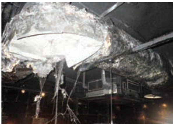
写真 8-1 排気ダクトの焼損状況
