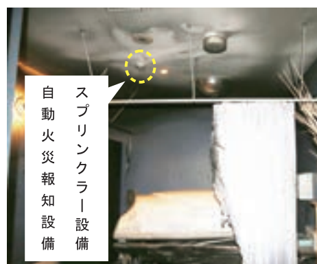
写真 6-10-2 出火箇所の状況
