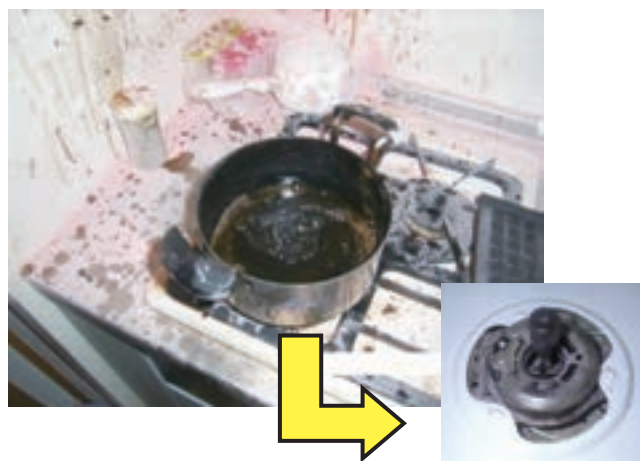
写真 3-1-2 ガステーブルの状況 (安全装置の状況)
