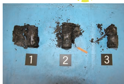
写真 6-1-2 進相コンデンサの焼損状況
