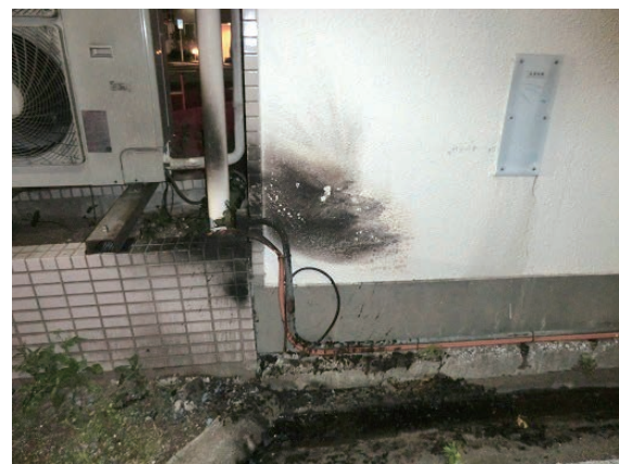
写真 2-1-2 焼損した外壁
