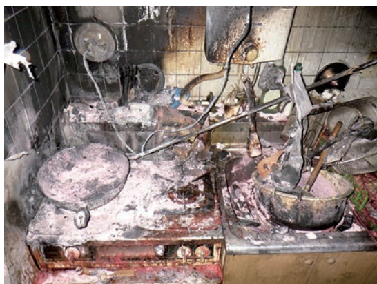
写真 3-1-1 台所の焼損状況
