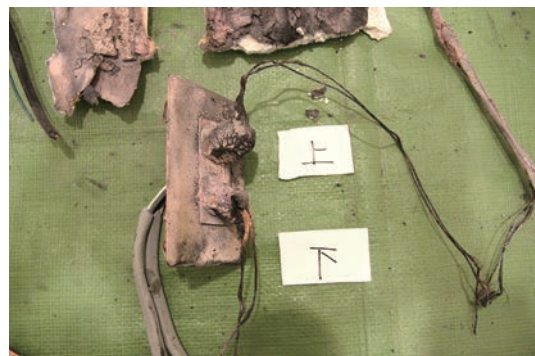
写真 8-2 配線焼損状況
