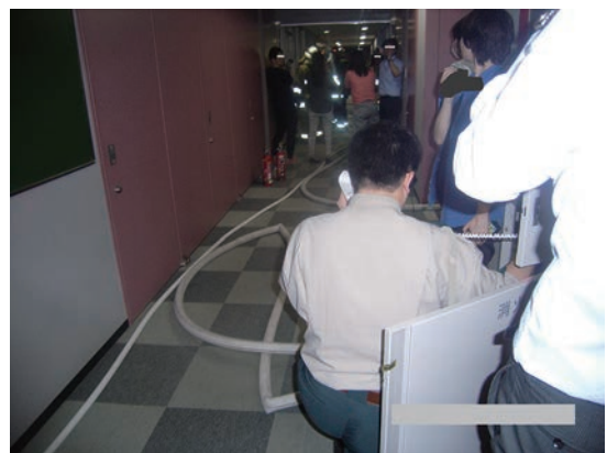
写真 7-2 補助散水栓の使用状況
