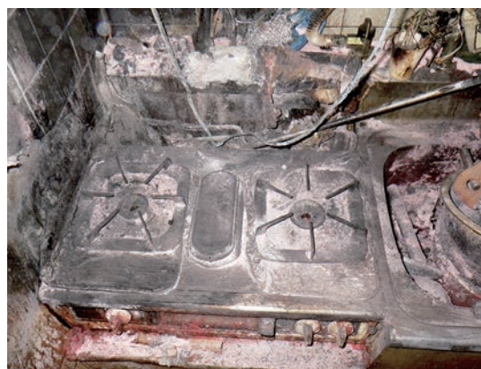
写真 3-1-2 ガステーブルの焼損状況
