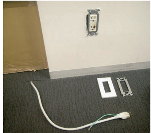
写真 6-9-1 使用していた壁付コンセント
