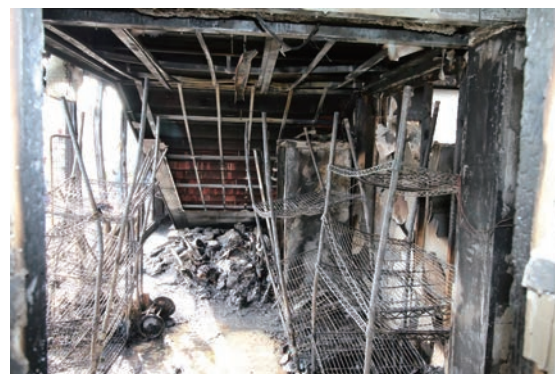
写真 8-1 階段下倉庫焼損状況
