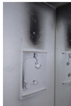
写真 6-4-1 内壁の焼損状況
