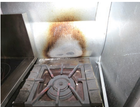
写真 6-2-1 大型ガスこんろの状況
