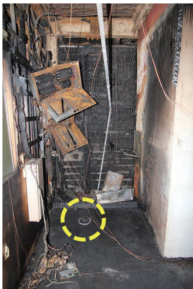
写真 6-1-1 動力用分電盤の状況
