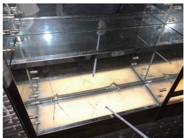
写真 3-4-2 破損したガラス棚の状況
