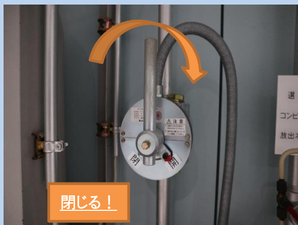
集合管に設置された 閉止弁の閉止例
