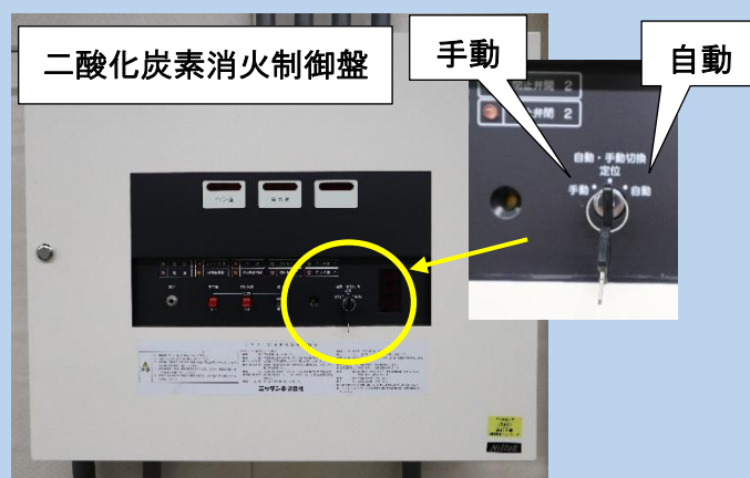
制御盤に設置された 自動手動起動切り替えの例
