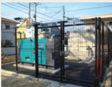
▲ 震災時多機能型深層無限水利(深井戸)
