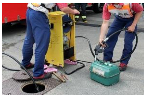
緊急用ポンプの使用例 【出典】北海道石油新聞社
