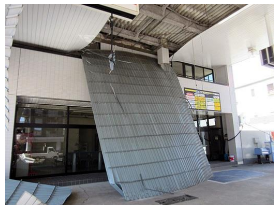
キャノピーパネルが落下した状況
