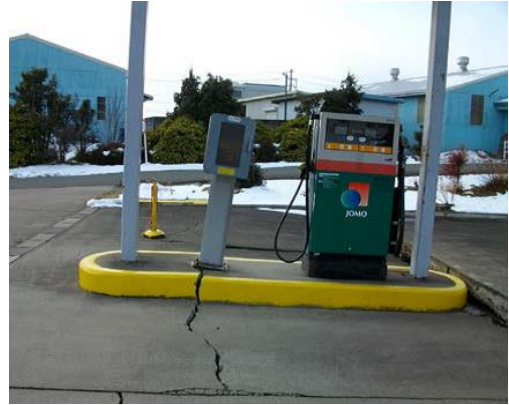
地盤面に亀裂が生じた状況 【出典】全国危険物安全協会
