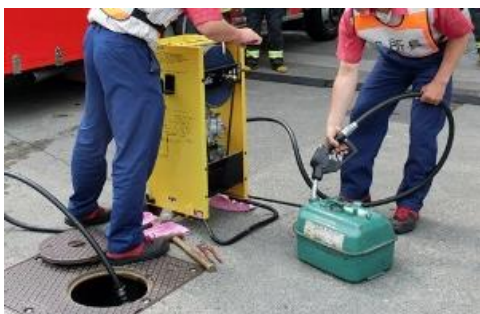
緊急用ポンプの使用例
