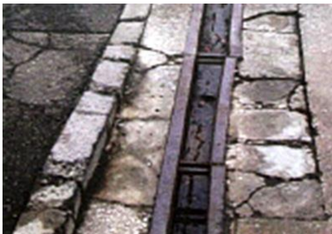
排水溝に亀裂が発生した状況 【出典】東京都石油業協同組合
