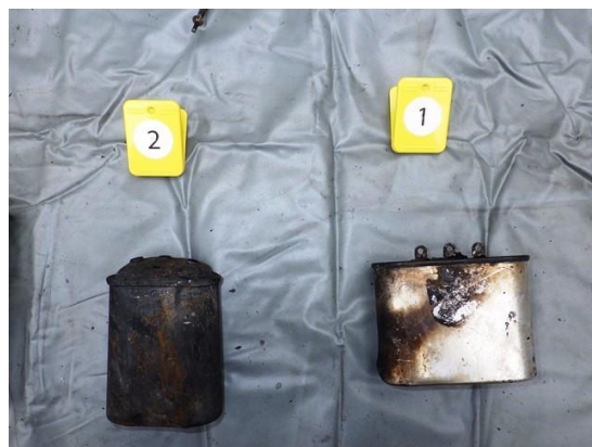
写真2 低圧進相コンデンサの焼損状況
