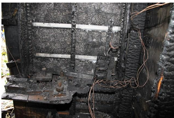
写真1 動力用分電盤の状況
