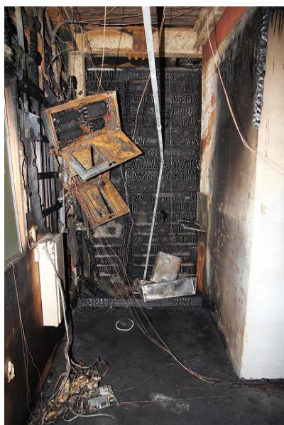
写真3 動力用分電盤の状況
