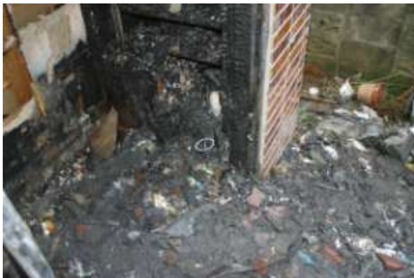
写真2-1 仏壇付近の状況
