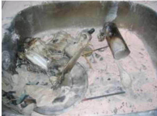
写真 2 流し台シンク内の状況
